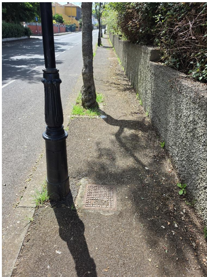
Árbol y farola en la acera, limitando o impidiendo la movilidad
